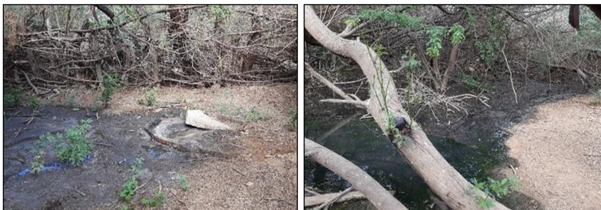
Figura 3. Manjole rebosado y laguna de aguas residuales.
