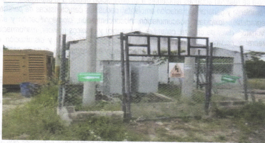
Equipo tipo transformador en estado de USO propiedad de la empresa Grodco ubicado dentro del área de minería. Septiembre 20 de 2016 - empresa CI GRODCO S.C.A. INGENIEROS CIVILES.
