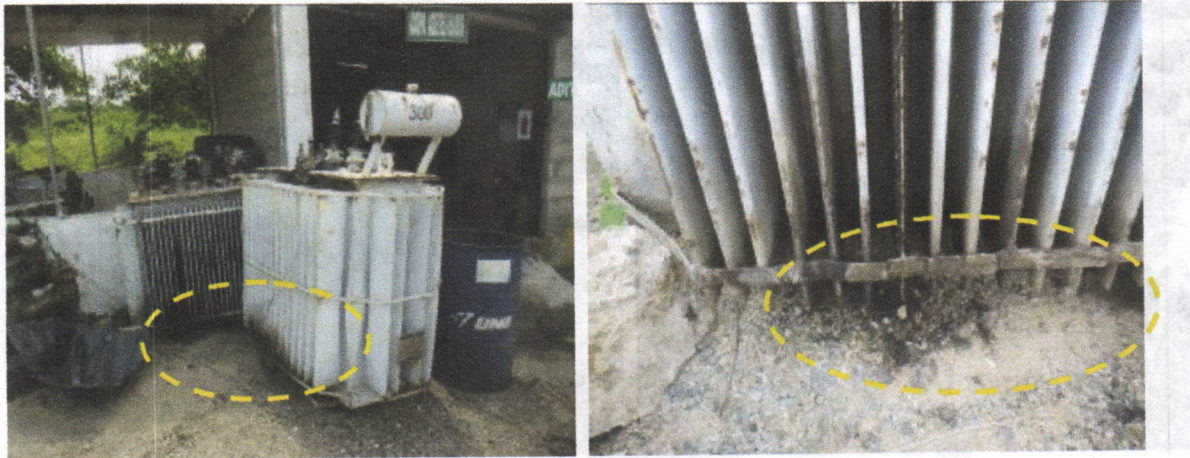
Equipos tipo transformador eléctrico en estado de DESUSO propiedad de la empresa Grodco ubicado dentro del área de minería – Derrame de Aceite aislante sobre el suelo. Septiembre 20 de 2016 - empresa CI GRODCO S.C.A. INGENIEROS CIVILES.
