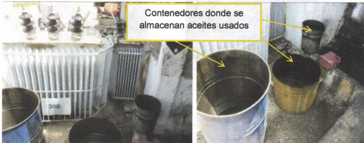
Contenedores donde se almacenan hidrocarburos (aceites usados, ACPM) expuestos a condiciones climáticas y de fácil acceso a los animales que habitan en la zona. Septiembre 20 de 2016 - empresa CI GRODCO S.C.A. INGENIEROS CIVILES.
