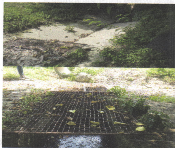
Sistema de retención de aceites y grasas de las aguas residuales industriales.
