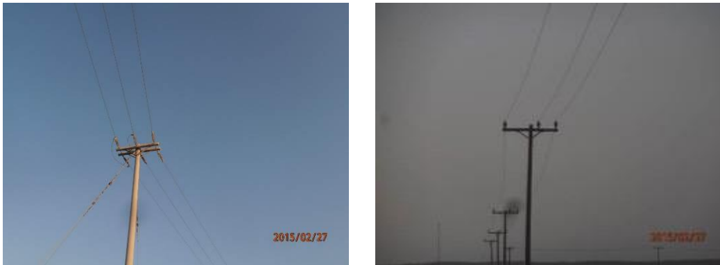
Figura 12. Cables de transmisión eléctrica sin uso en la localidad de Carrizal.
