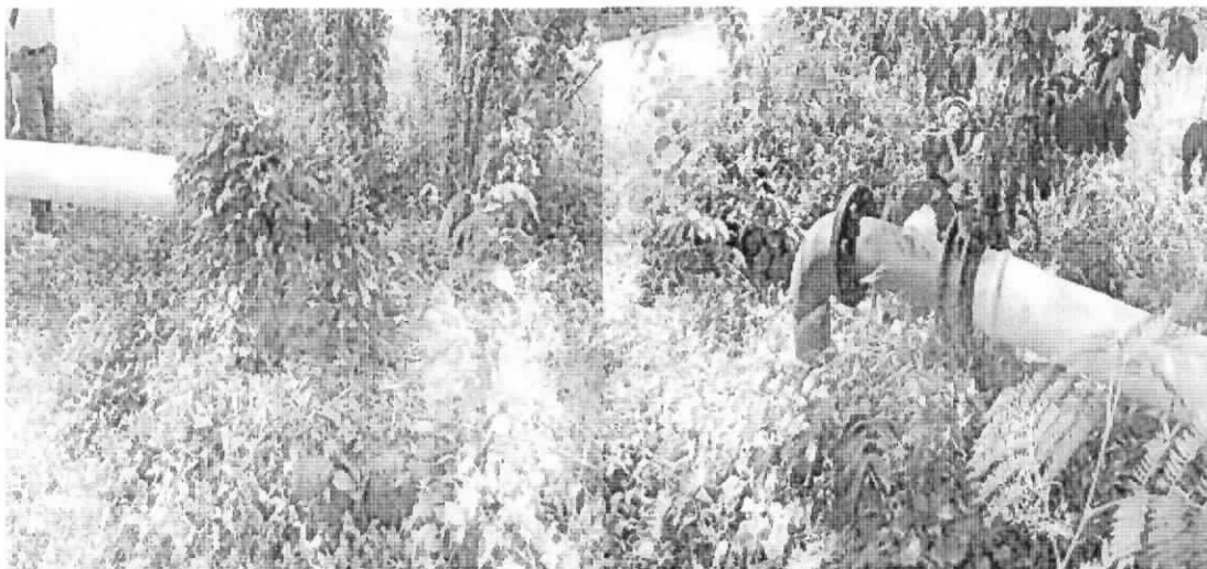
Fotografias 9 Pozo sur reservorio finca Canadá
