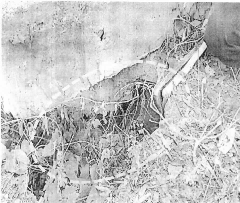
Imagen 16. Desestabilización del pozo profundo por erosión y esvancamiento
