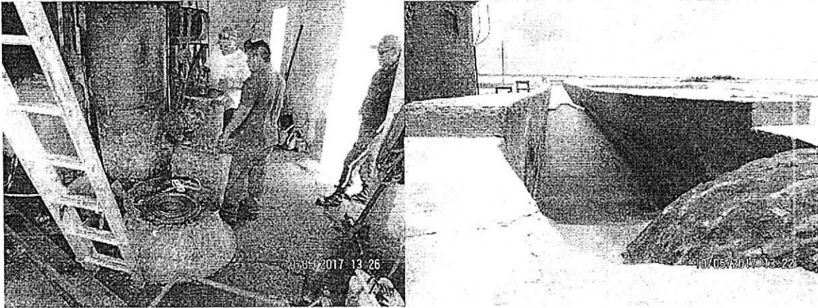
Fotos 1 y 2. Visita al sistema de Bombeo
