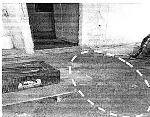
Fotografías No 18. Ausencia de piso rígido en algunas partes dentro del área donde se encuentran los generadores de energía.
