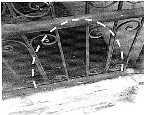
Fotografías No 19. Piso con aceite pegado y de aspecto gomoso.
