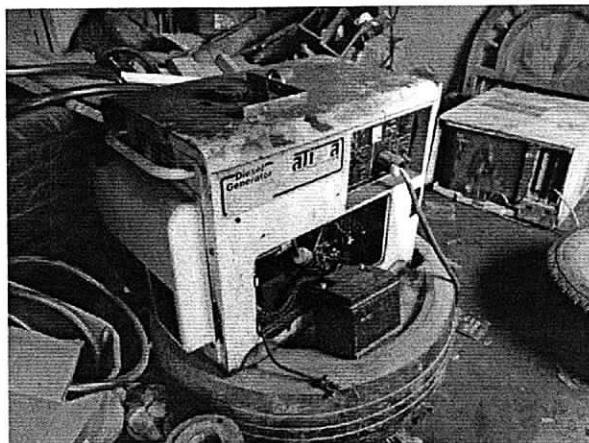
Foto 5: Planta Eléctrica de la EDS COMBUSTIBLES KARY
