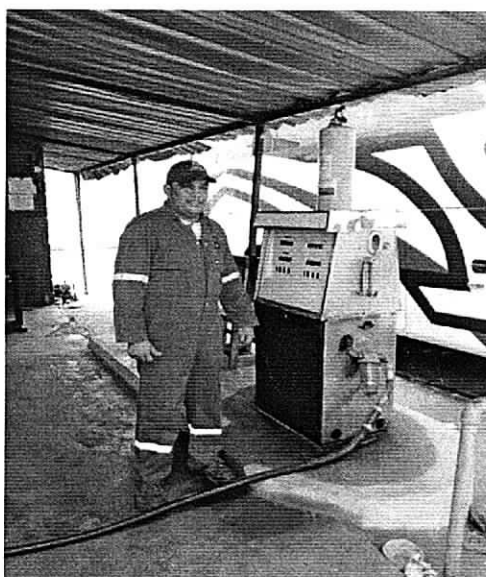
Foto 10, 11 y 12: Extintores de la EDS Combustibles KARY
