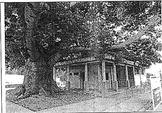
Un acercamiento de la infraestructura y las ramas por encima del tejado
