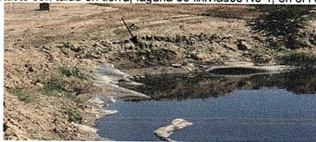
Fotos N 10. Potencial rompimiento de talud de la laguna de lixiviados No 1 en uno de sus vórtices por infiltración de lixiviados en el talud en tierra colocada en su redor en el RSRSG . Noviembre de 2018
