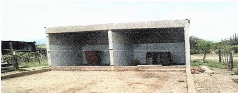
Foto No 50. Cuarto de RESPEL con berma de protección. 8 de junio de 2017
