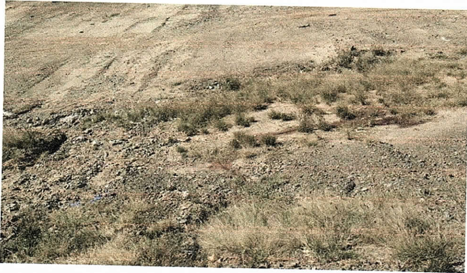
Foto No 18. Filtración de lixiviado en parte baja del talud de la Celda No 1. Noviembre 30 de 2018
