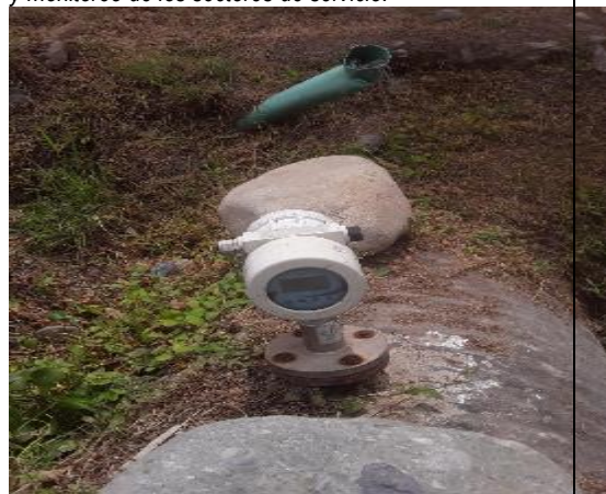
Fotografía 1. Caudalímetro ubicado entre el desarenador y la planta del Distrito de Riohacha. (Fuente. ASAA. S.A E.S.P 2020)
