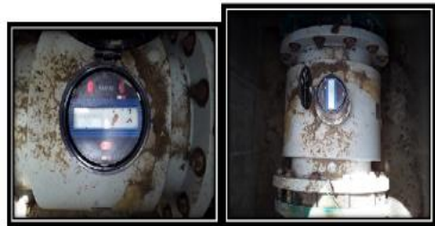
Fotografía 5. Sistema de medición de caudal pozo Guayacanal(Fuente. ASAA. S.A E.S.P 2020).
