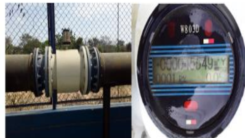
Fotografía 4. Sistema de medición de caudal pozo la Luchita (Fuente. ASAA. S.A E.S.P 2020).
