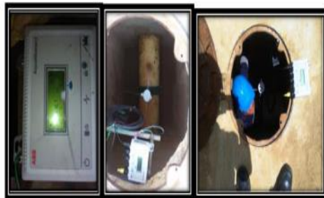
Fotografía 6. Sistema de medición de caudal y volumen en los sectores hidráulicos(Fuente. ASAA. S.A E.S.P Informe de cumplimiento 2019).
