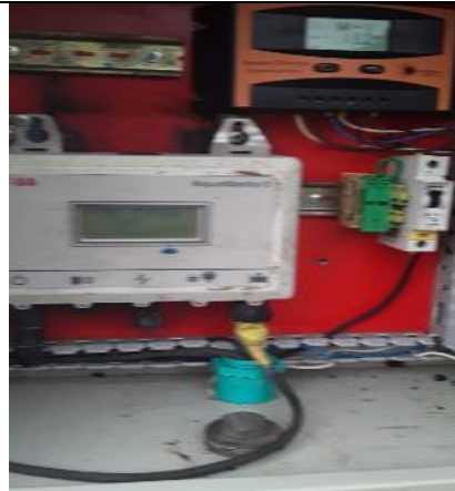
Fotografía 3. Sistema de medición de caudal en la salida de la PTAP del Distrito de Riohacha. (Fuente. ASAA. S.A E.S.P 2020)
