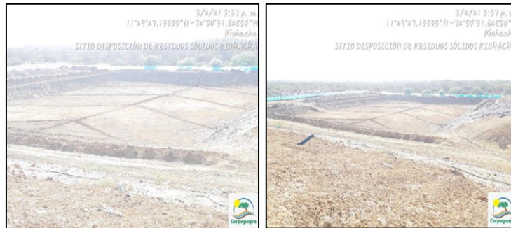
Fotos 65 y 66. Construcción de drenajes de lixiviados en forma de espina de pescado que además sirve de intercomunicación entre chimeneas para la evacuación de gases. 3 de febrero 2021. Fuente CORPOGUAJIRA
