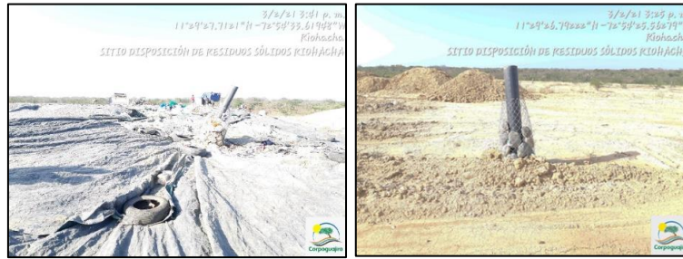
Fotos 62, 63 y 64. Chimeneas instaladas en el sitio de disposición final. 3 de febrero 2021. Fuente CORPOGUAJIRA
