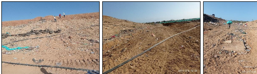
Fotos 59, 60 y 61. Mangueras para recirculación y manjol o pozo de inspección. 3 de febrero 2021. Fuente CORPOGUAJIRA
