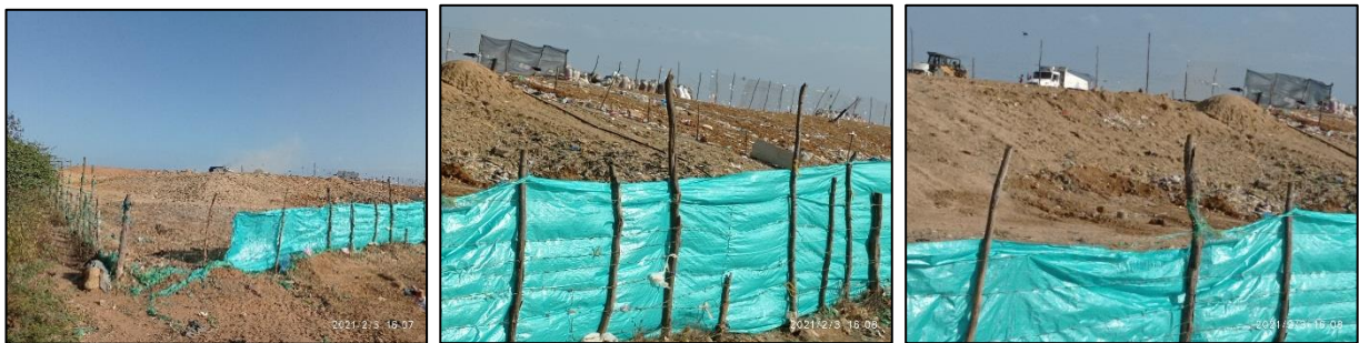
Fotos 44, 45 y 46. Estado de mallas y lona verde para control de residuos volantes visto desde el área externa de las celdas. 3 de febrero 2021. Fuente CORPOGUAJIRA
