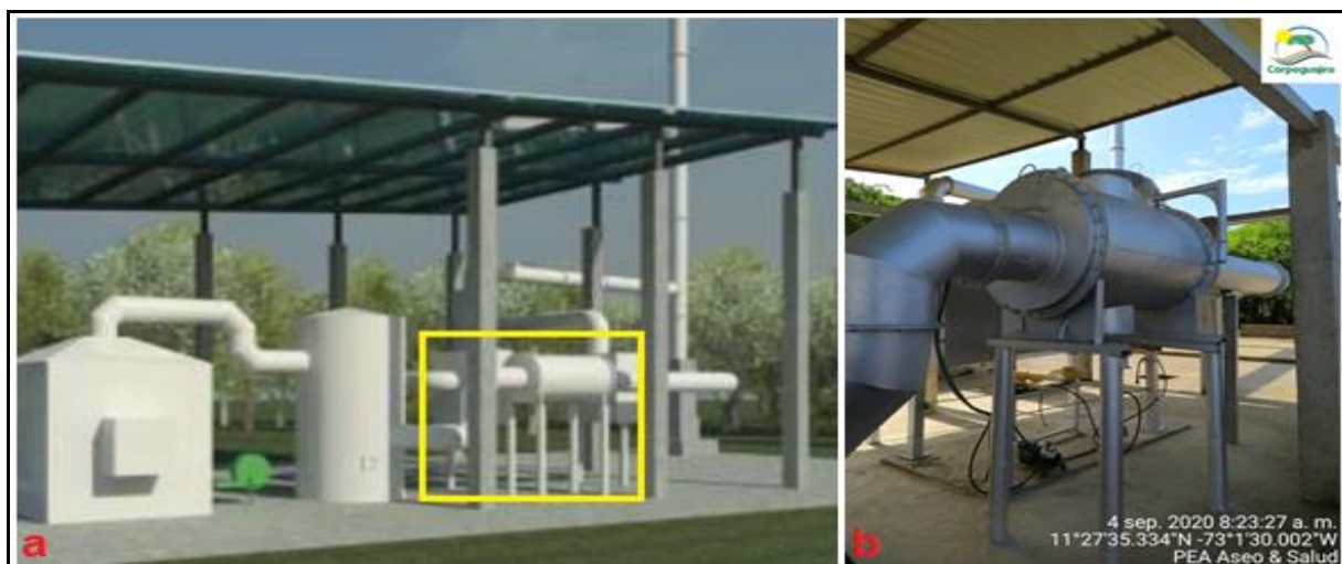
Figura 5. a. Ubicación del Scruber o lavador de gases y b. Scruber o lavador de gases.
