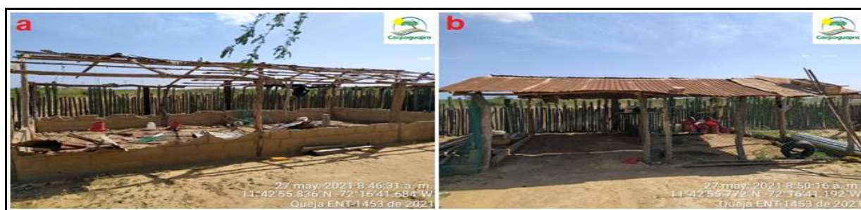
Figura 1. a) Galpón desarmado y b) Galpón con techo en mal estado.
