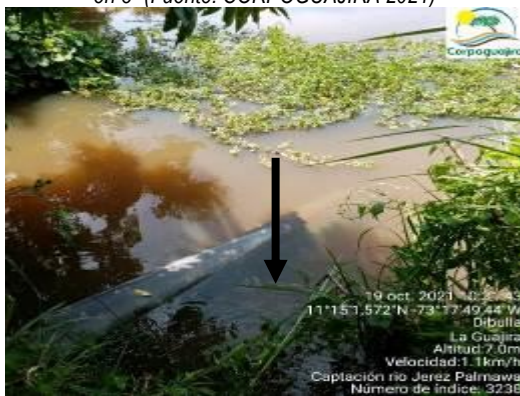
Fotografías 2. Tubería de entrada al Reservorio para almacenamiento de Agua (Fuente: CORPOGUAJIRA 2021)
