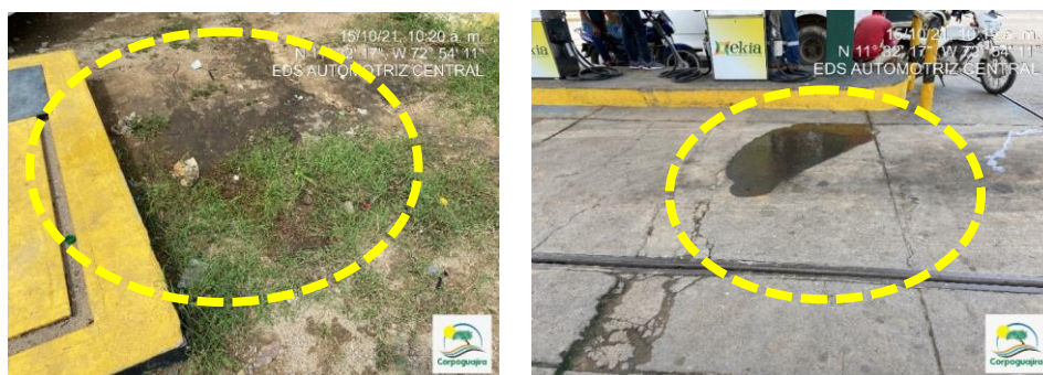
Fotografía No.7-8: Vestigios de derrame de hidrocarburos. ESTACION DE SERVICIO AUTOMOTRIZ CENTRAL. 15 de octubre de 2021.
