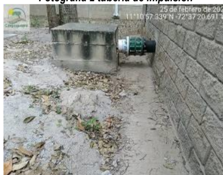
Fotografía 2 tubería de impulsión
